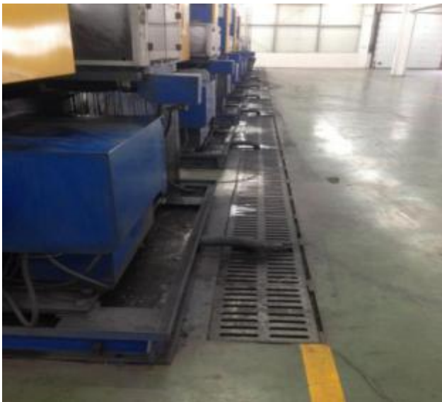
图 4-1 车间内排水管网
